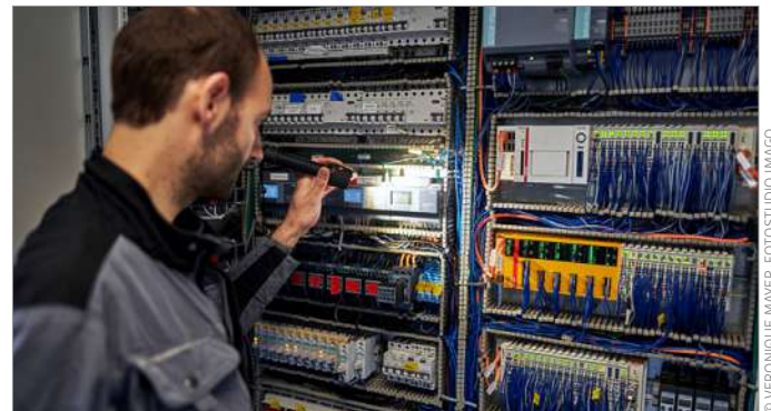
In der Schaltzentrale Jeremias Weinrich, Mitgründer und CPO, kontrolliert den Schalt- und Steuerschrank einer Anlage
