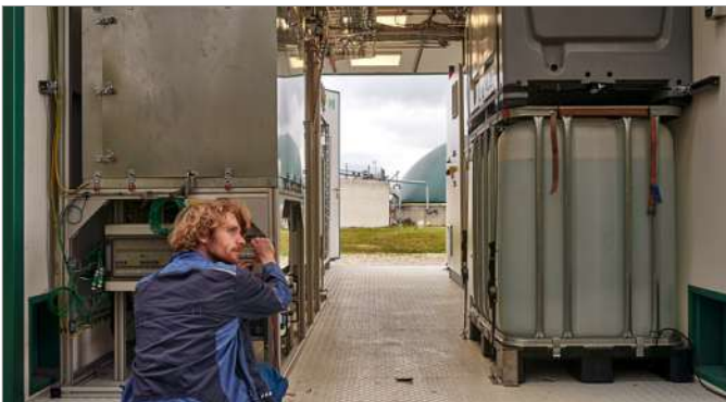
Blick ins Kraftwerk Mitgründer und CTO Maximilian Hauck arbeitet an einem Reverbion-Kraftwerk
